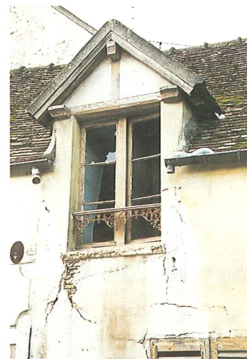
Érosion accélérée de l'enduit par le passage incessant de l'eau de pluie (fuite d'eau et ruissellement).
