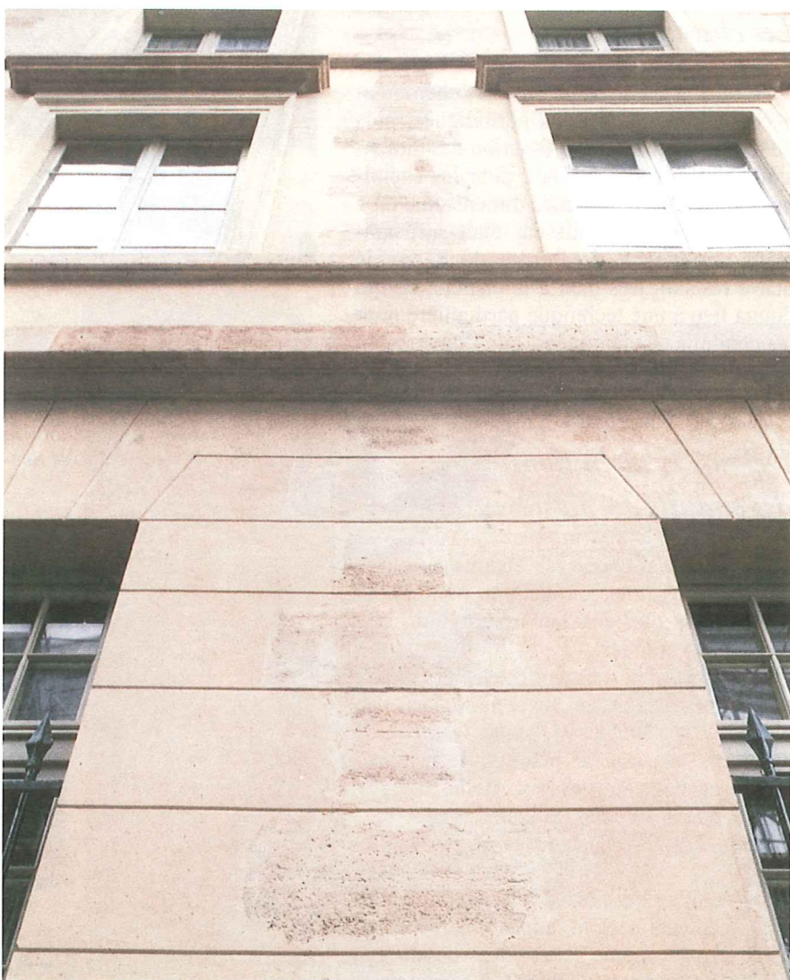
Enduit contemporain en plâtre et chaux teinté dit "de Montmorency" (lycée Henri IV, Paris).
